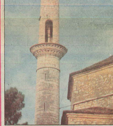
Yanya'daki Fethiye Camii'nin minaresinin kurşunları sökülümüş, şerefe korkulukları tahrip edilmiş.
